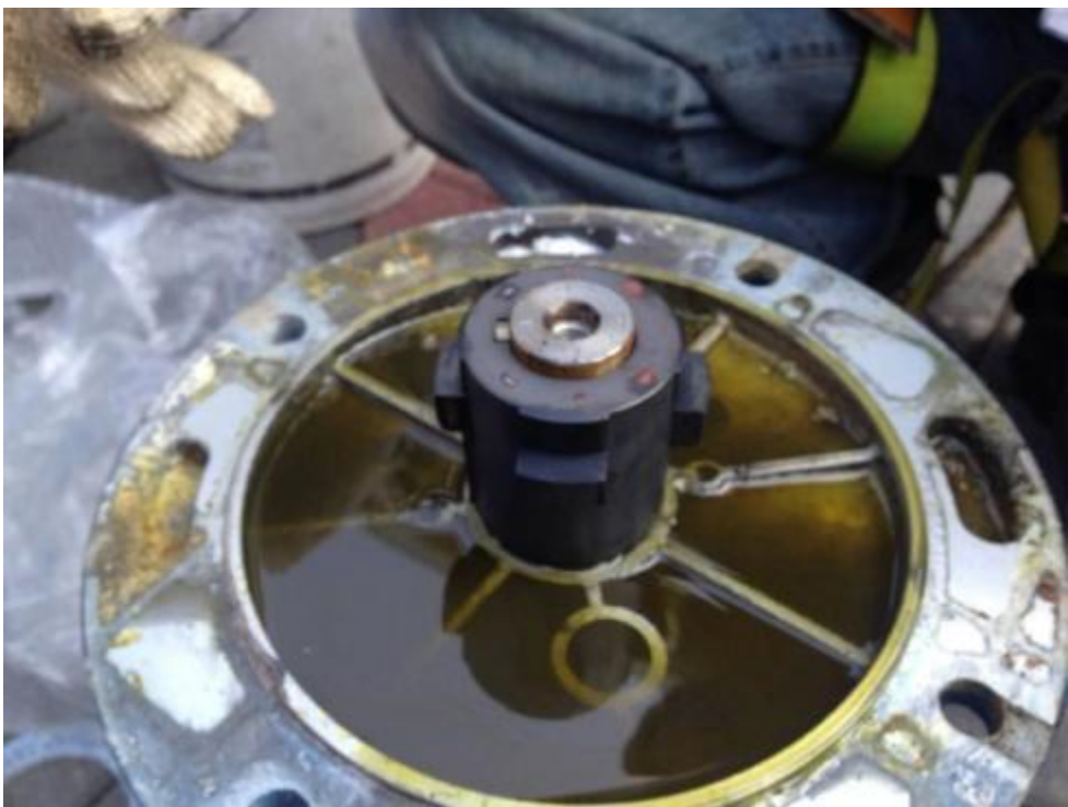
照片2：驅動馬達拆解時內部積油情形。
